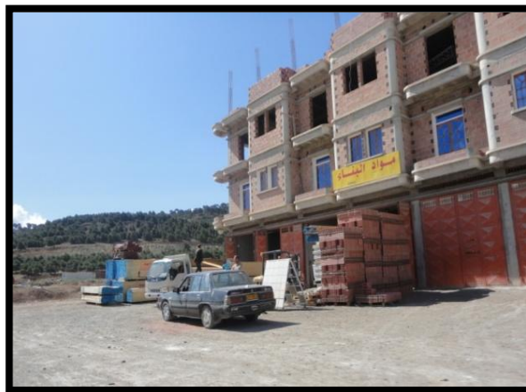
Photos.23 : constructions sans permis de construire
