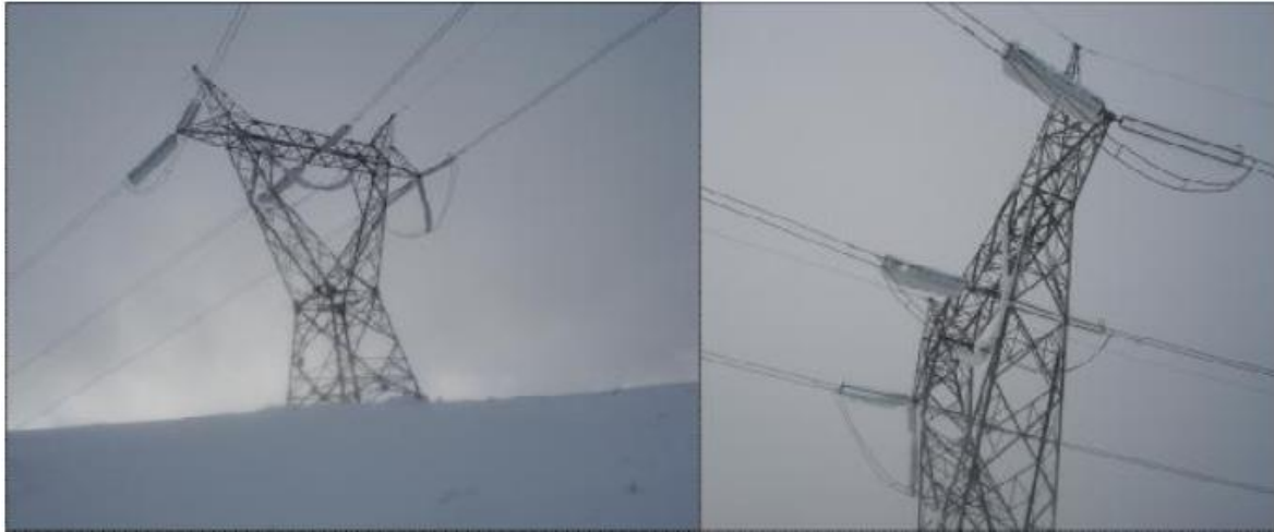
Figure1.1. Incident enregistré (DRD) le 16 Décembre 2008 à 00h28. (LIGNE 400kV EL AFFROUN - BIR GHBALOU).
