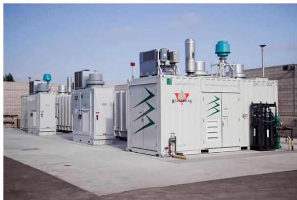
Figure1.7 : unité de pile combustible
