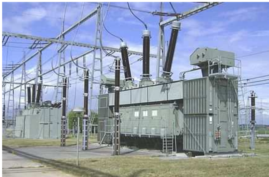
Figure II.3 : Transformateur de puissance dans un poste électrique.
