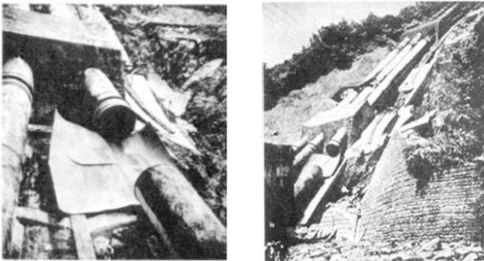
Figure I.3: Vue d'une conduite forcée éclatée de la centrale électrique d'Oigawa, du Japon.
