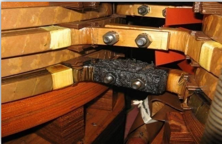
Fig. III.4. Point chaud sur connexion boulonnée [6]
