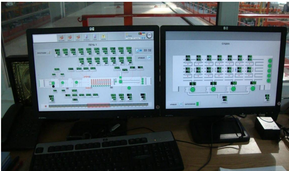
Figure 1.13 Image de la salle du contrôle.
