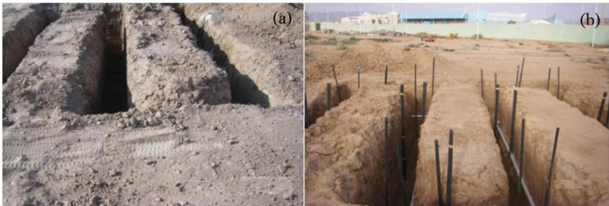
Figure. I. 17. Photos de l'installation expérimentale d'EAHE à l'Université de Biskra, a) trou de forme serpentine; (b) PVC horizontal enterré tuyau avec thermocouples [18].
