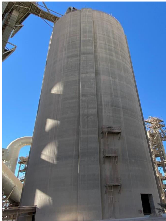
Figure I.5. Photographie d'un silo d'homogénéisation [3]
