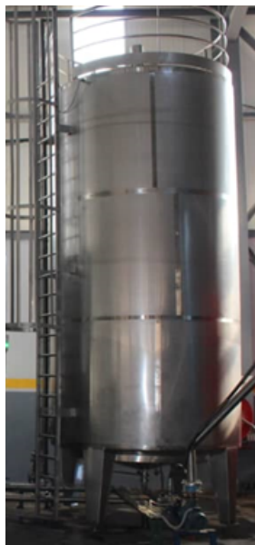
FIGURE IV.3 – Bac de stockage produit fini
