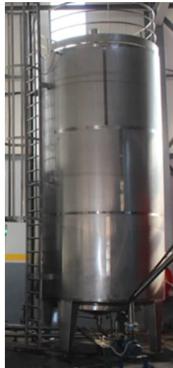
FIGURE IV.1 – Bac de stockage de la matiere premier
