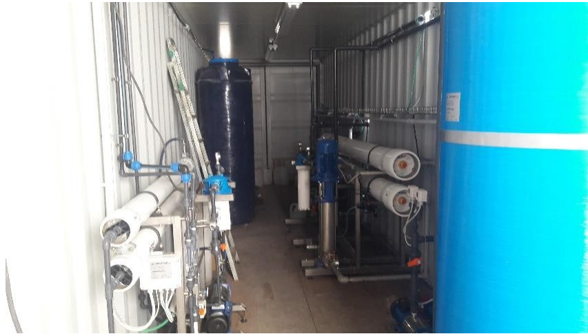
FIGURE I.6 – Unité de traitement d'eau
