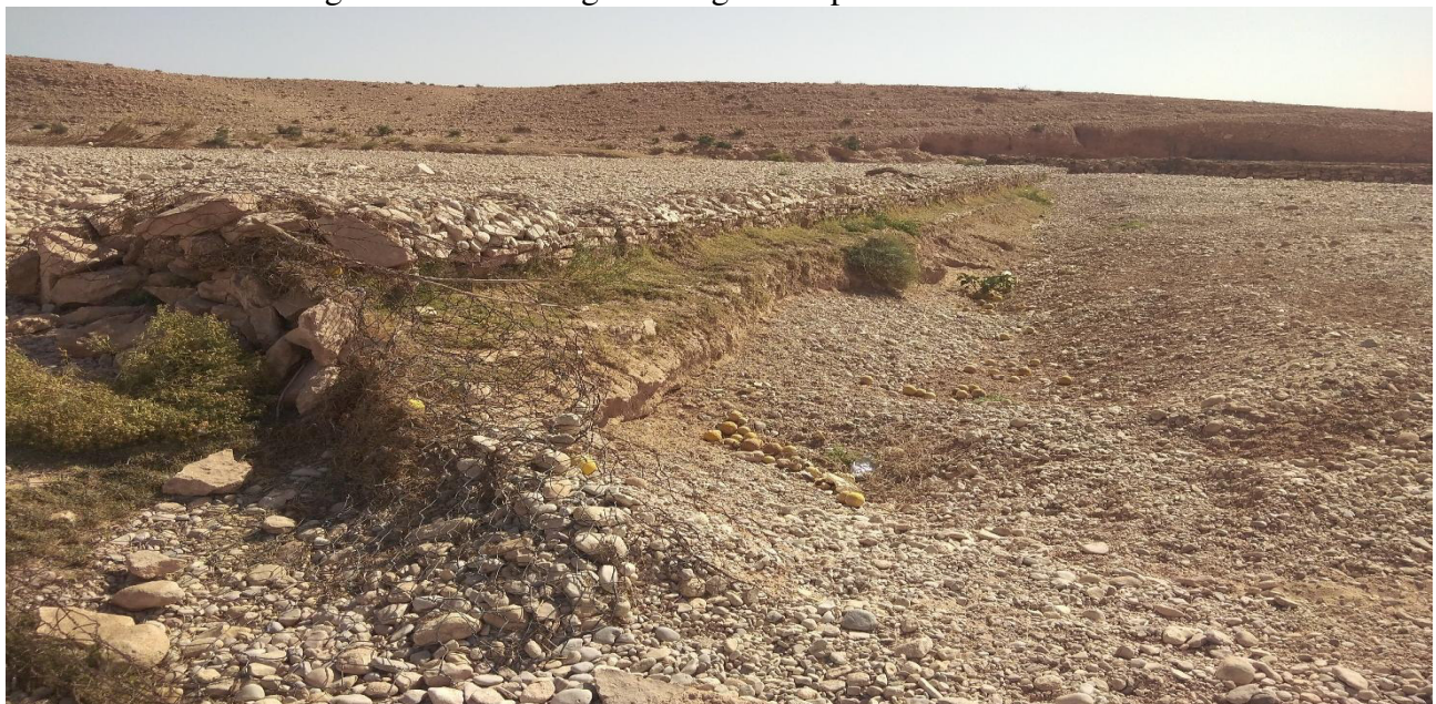
Figure III-10 l'état actuel de la digue
