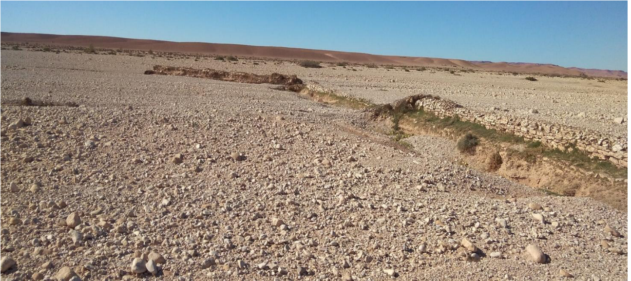
Figure III-8 Partie centrale du ced détruite suite au passage d'une crue exceptionnelle
