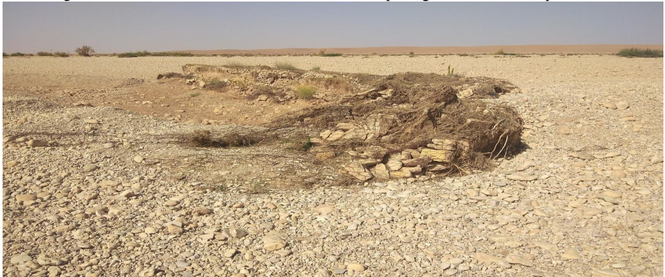
Figure III-9 Etat du gabionnage de la partie détruite du ced
