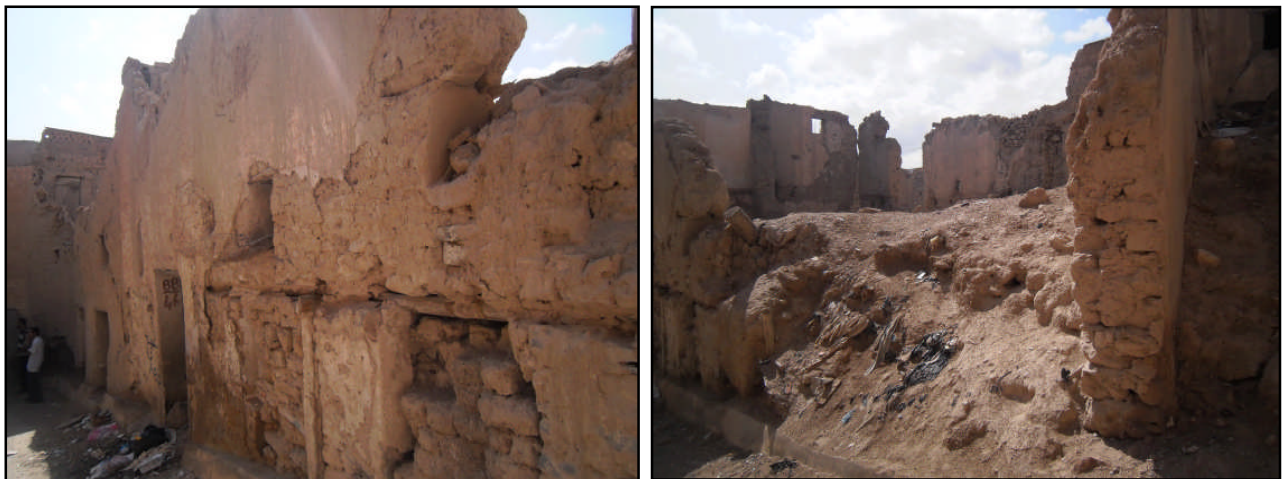
Photos 41 : Un état de délabrement avancé subit les constructions de la médina de Bou-Saada. Source : Auteur, 2011
