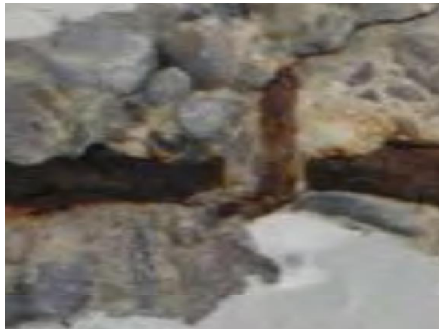
Figure II. 3 : Eclatement du béton d'enrobage dû à la carbonatation [Vu, 2011].
