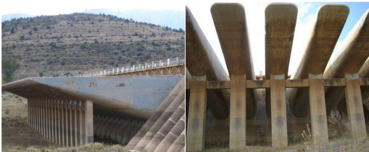
Figure II.4. Vue de déversoir en labyrinthe du barrage Beni Bahdel –Algérie
