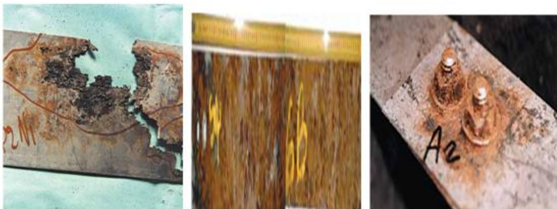
Figure 1.50 Corrosion des renforcements métalliques
