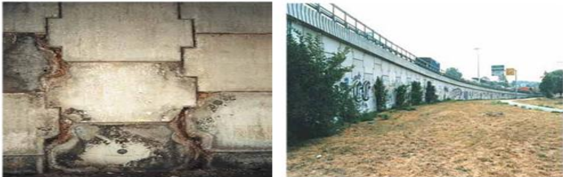
Figure 1.54 Dégradation du béton d'une écaille par réaction sulfurique externe et défaut d'entretien
