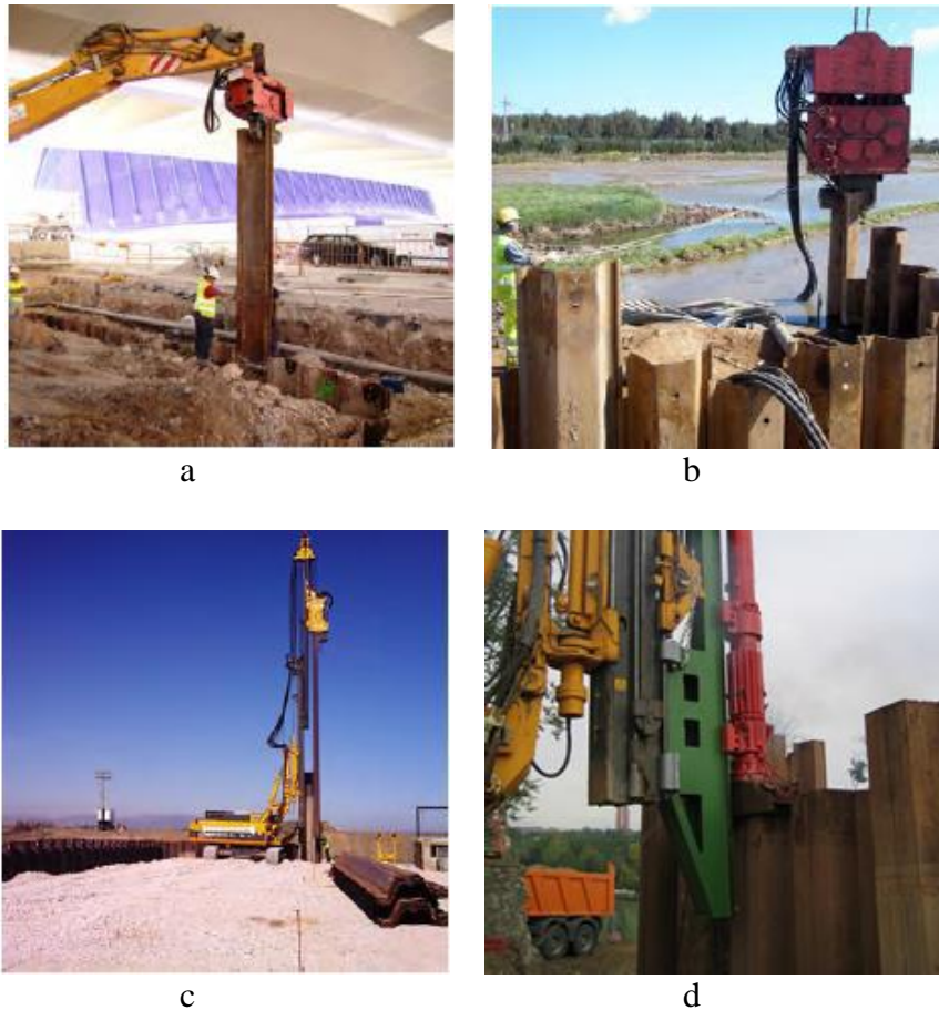
Figure 1.8. (a) Vibrator Hammer. b) Vibrator accroché. c) Vibrator sur l'équipement auto-transportable. d) à percussion ou le frapper. Ischebeck (2014).
