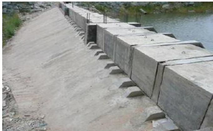
Figure I.35 Blocs fusibles sur un seuil avec des murs séparateurs
