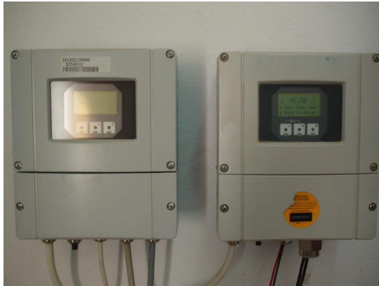
Figure III.6 Débitmètre à ultrason Flowmeter 93W2
