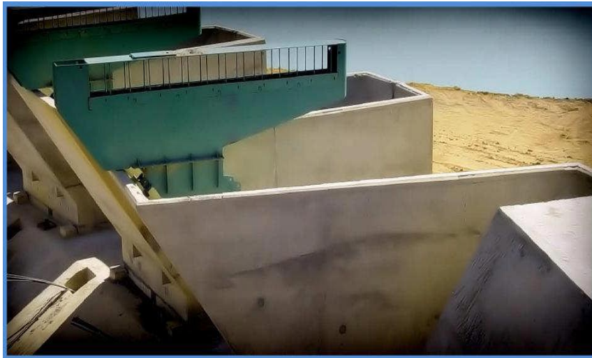
Figure I.19 Puits d'alimentation solidaire de la hausse (en acier)
