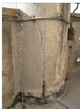
a) tâches de rouille+ fissuration
