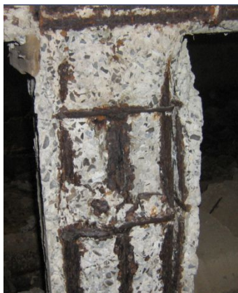
Photo III-1 Corrosion avancée des amorces poteaux
