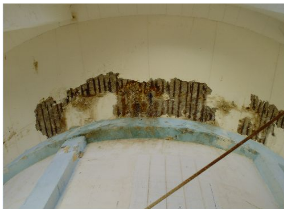
Photo III.13 : Corrosion de quelques armatures apparentes de la coupole inférieure de la cuve
