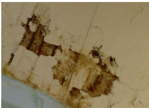
Photo III.14 : Eclatement du béton en certains endroits de la coupole inférieure
