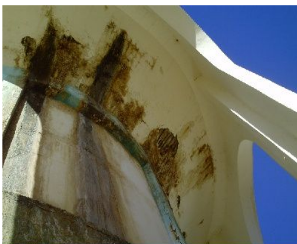
Photo III.15 : Traces d'infiltration d'eaux colmatées par le temps au niveau de la coupole inférieure de la cuve et des éléments structuraux
