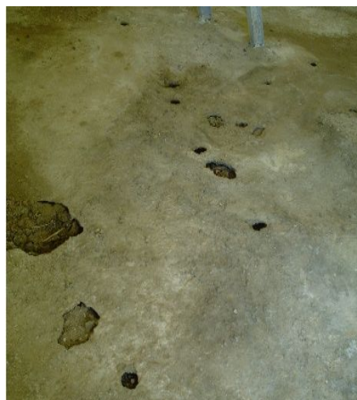
Photo III.10 : Perforations au niveau de plate forme
