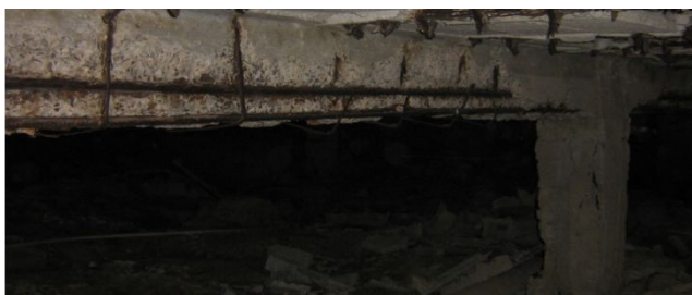
Photo III.3 : Effondrement du béton d'enrobage avec l'apparition des armatures très corrodées
