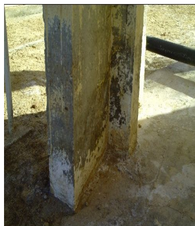
Photo III.12 : Trace de calcite de couleur blanchâtre et fissurations au niveau de plate forme
