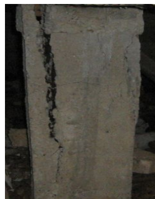
Photo III-2 détérioration du béton d'enrobage
