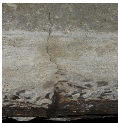
Photo III.4 : Fissuration transversale à mi-travée à travers l'hauteur de la poutre
