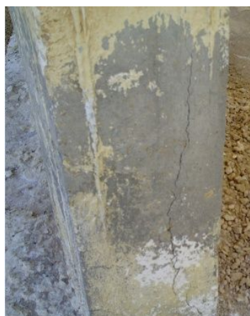
Photo III.11 : Fissure axiale sur un poteau en BA
