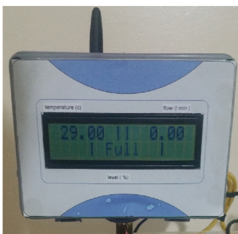
Figure 4.28 Affichage local de niveau Château d'eau plein
