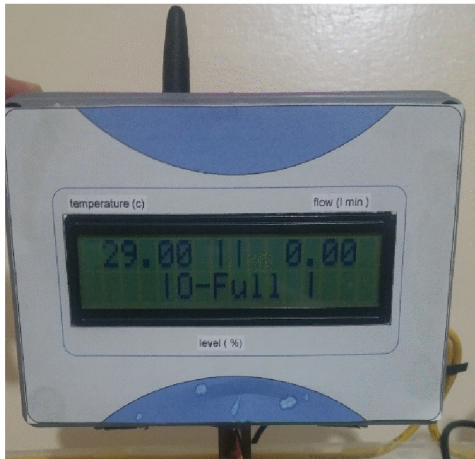
Figure 4.30 Affichage local de niveau Château d'eau trop plein
