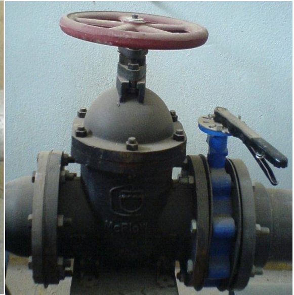
Fig6. Système de vannage
