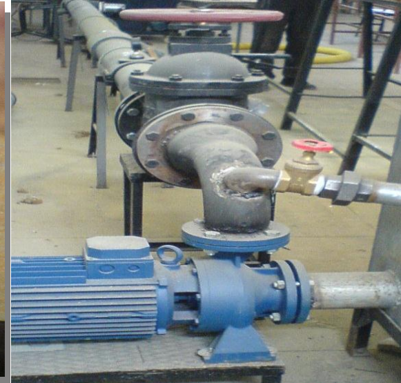
Fig8. Pompe + système de vannage
