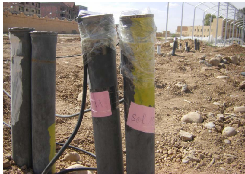
Figure III.12 : Sondes de mesure de la température de l'air en circulation à travers l'échangeur et dans le sol
