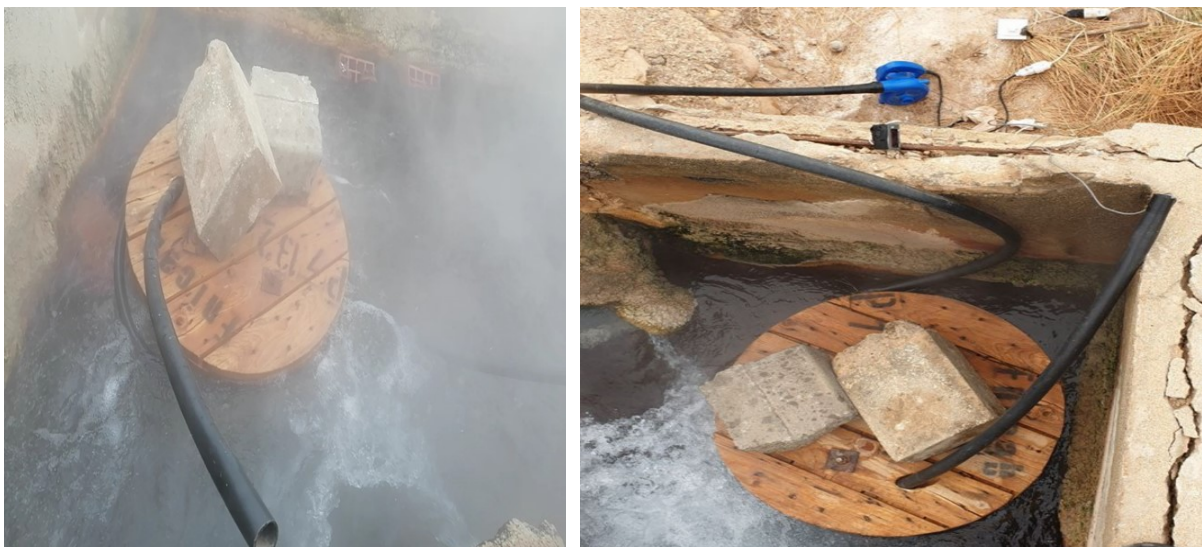
Figure III.1 : Échangeur de chaleur monotube de 21,5 m de long (première expérience de chauffage de l'air 09 /02 /2024).
