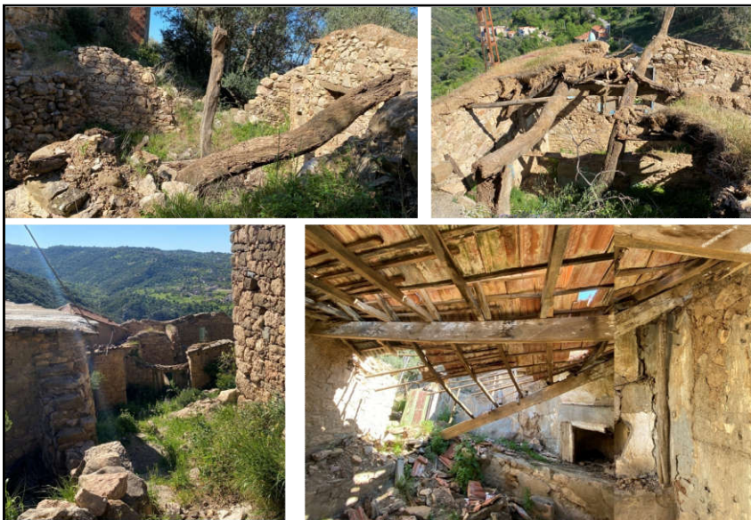
Photo 3 - 10 : Maisons traditionnelles totalement effondrées dans le sous-secteur I de Ait El Kaid.
