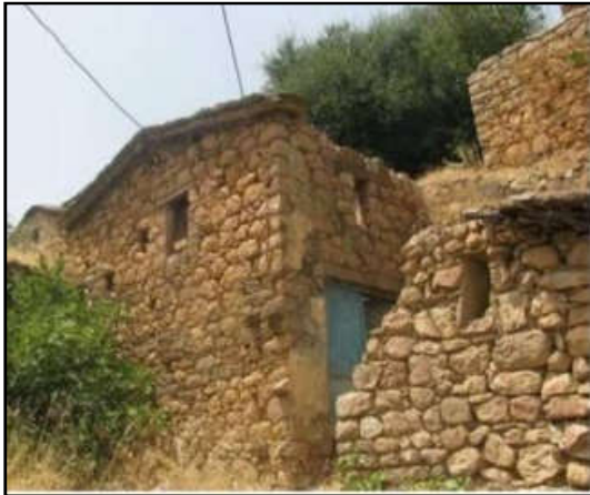
Figure 3 - 13 : Exemple d'une bâtisse partiellement effondrée.
