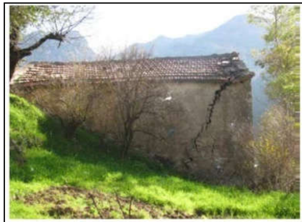
Figure 3 - 10 : Exemple d'une bâtisse traditionnelle encore debout mais représentant des anomalies structurelles
