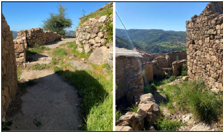
Photo 3 - 13 : Etat des ruelles dans le secteur sauvegardé de Ait El Kaid. Source : Auteure, 2023.
