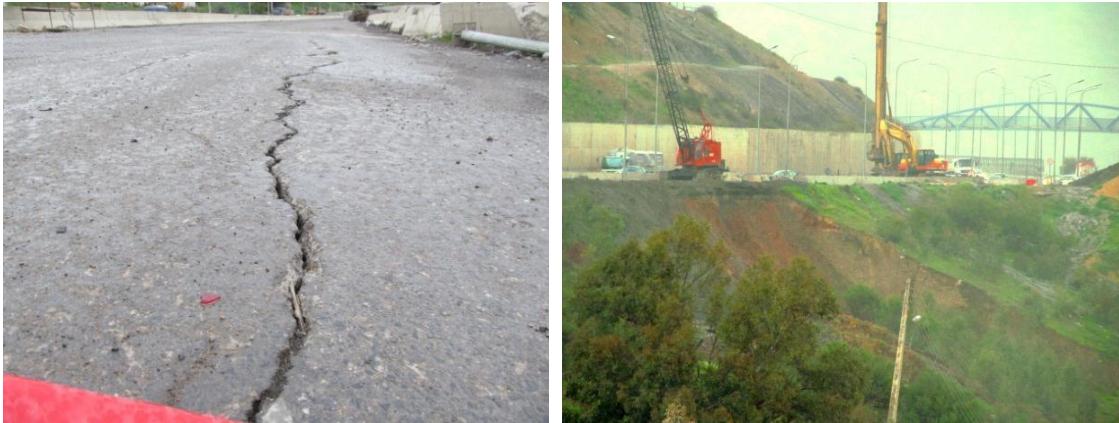
Figure 3.1 Glissement du tronçon Buira-Alger (Mars 2014).
